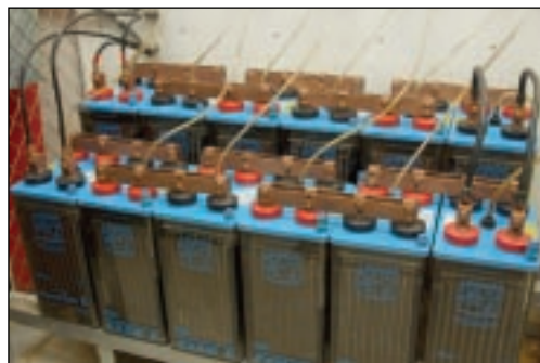
بطاريات احتياطية تعمل في حال انقطاع التيار الكهربائي عن وحدة التحكم
