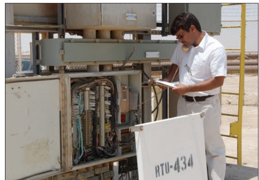
حمدان المطيري، يتابع أعمال الصيانة للتأكد من أداء وحدة التحكم
